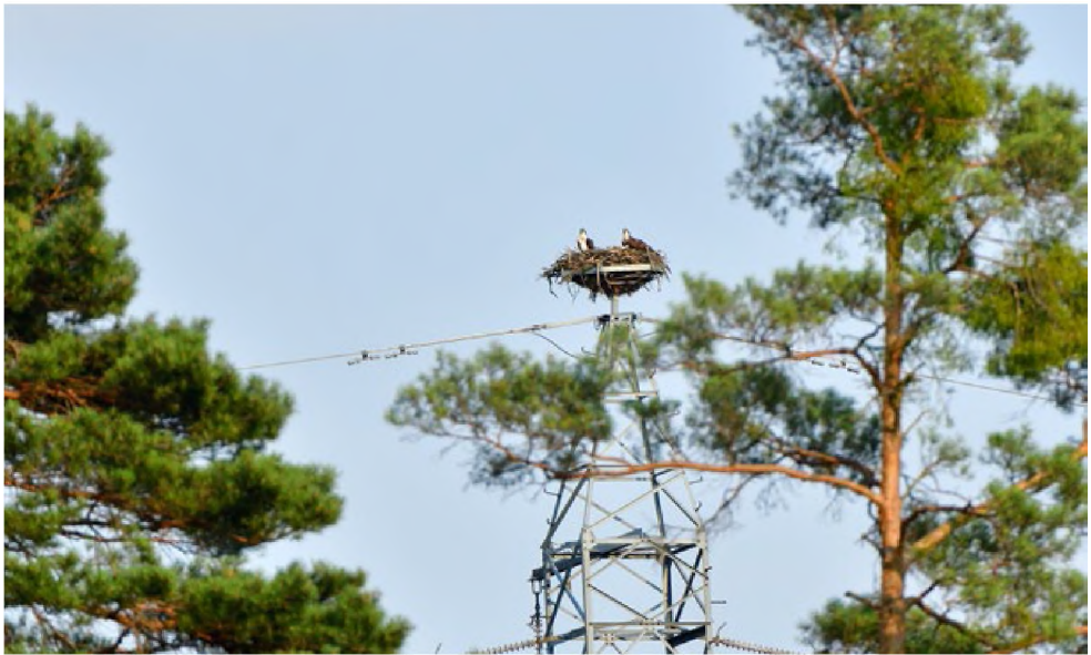
Fot. 1. Platforma łęgowa na czynnym słupie energetycznym wysokiego napięcia, zajęta przez rybołowy Pandion haliaetus , województwo lubuskie, 2018 rok (fot. M. Bielewicz).
